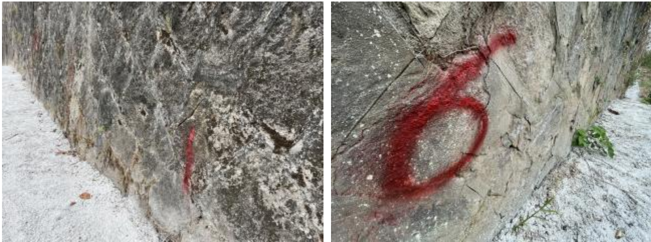
图 3、4.墙面开裂松动
