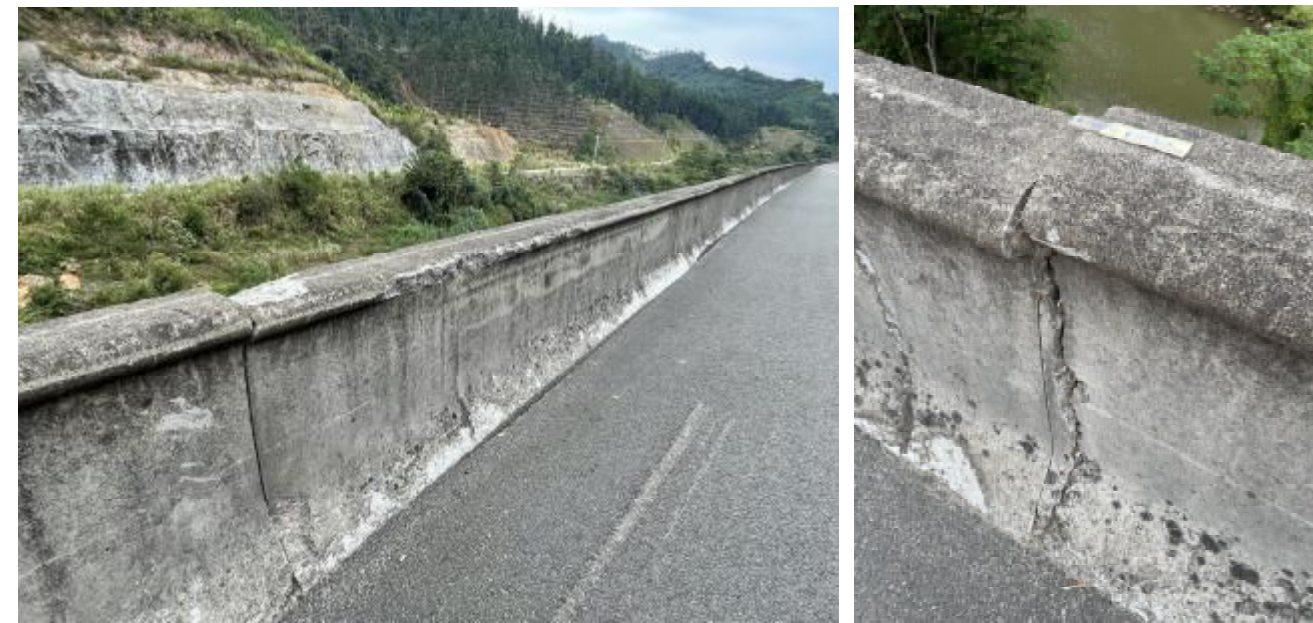
图 11、12. 路侧混凝土护栏伸缩缝错开
