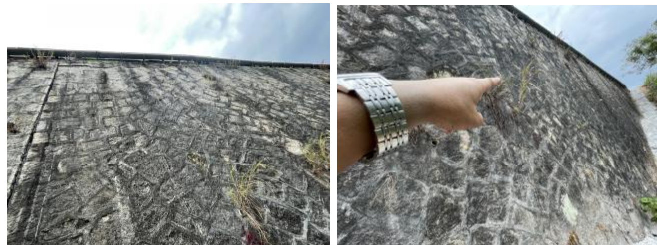
图 7、8. 大桩号墙身裂缝
