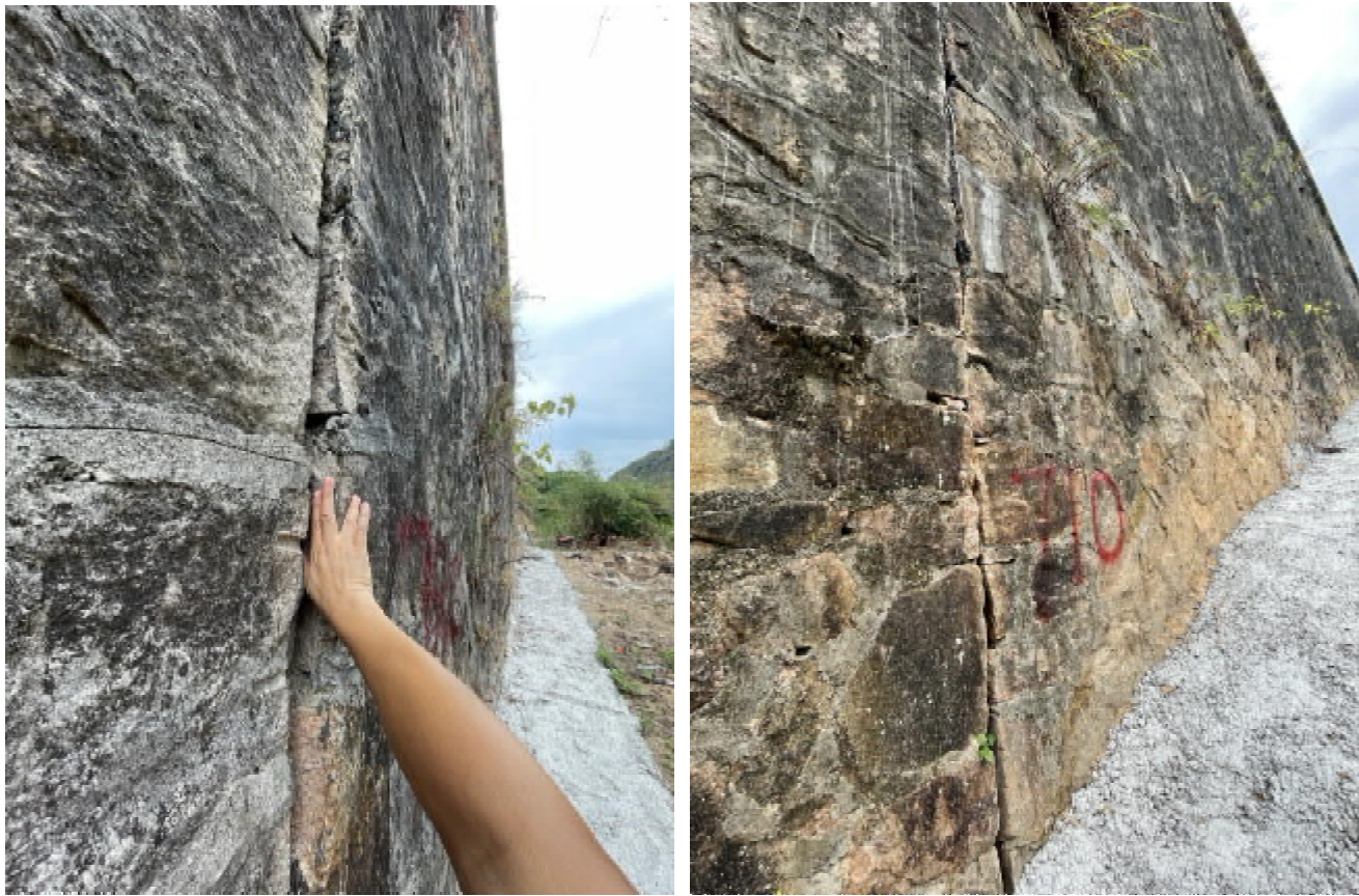
图 5、6.墙面伸缩缝错开
